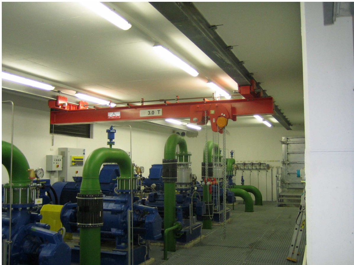
Sonderkran handbetrieben „ mit extrem kurzer Katze“ in der Pumpstation Sölden
